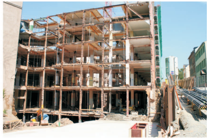
Neben dem Gebäude rechts lagern Mikrobohrpfähle, die unter die Neubauteile eingebracht werden. (im Prinzip das Fundament dafür)
