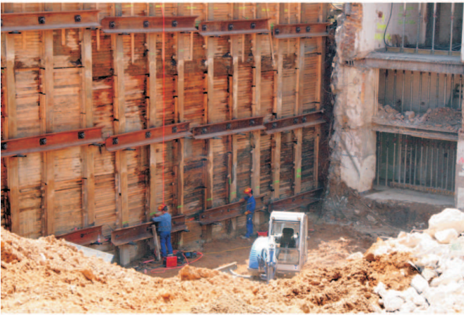
Verbauarbeiten in der Baugrube - sie dienen der Sicherung der sehr tiefen Baugrube.
